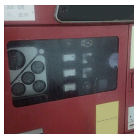
自家発電設備
